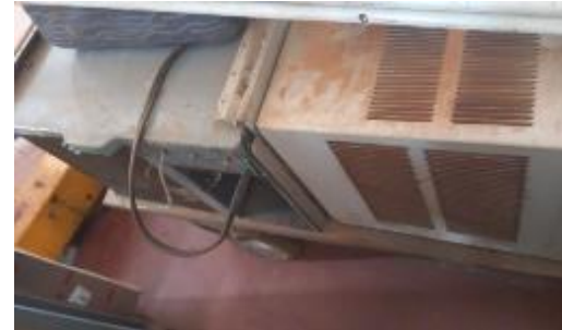
PN: SN: DESCRIÇÃO: AR CONDICIONADO QUANTIDADE: 2
